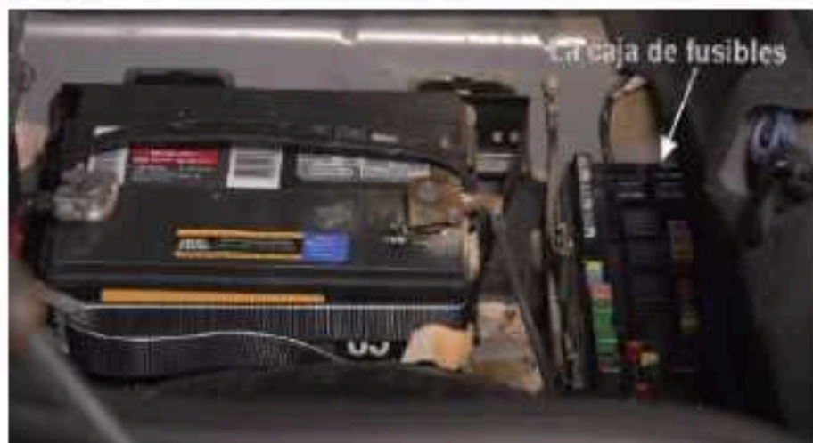
la caja de fusibles
